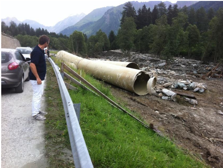
Erodierte Druckrohrleitung Oberstufe
