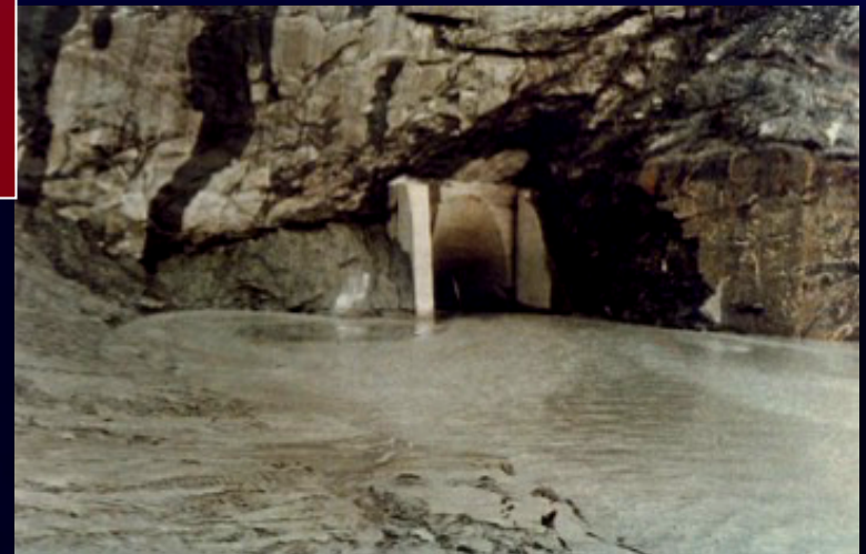
Sedimente vor Grundablasselinlauf bei Entleerung im Mai 1985
