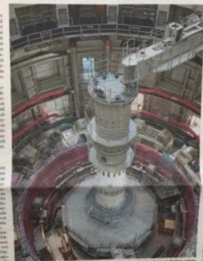
Für die Konstruktion wird ein besonderer Vakuumraum gebaut, der die kältesten Punkte mit bis zu minus 269 Grad Celsius erreichen kann.
